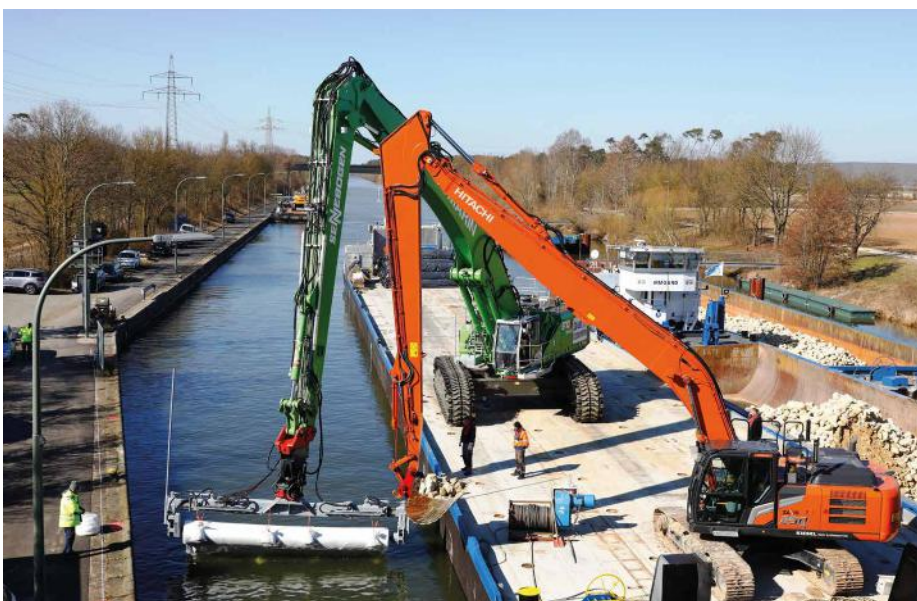
Im Zuge der Sanierungsmaßnahmen des Main-Donau-Kanals wurden in der Schleuse Strullendorf, Regnitz zum Erosionsschutz 18.100 m 2 Sandmatten eingebaut
