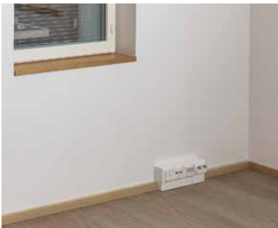
Abb. 62 Elektroinstallation mit Hilfe der Fußleisten hat seine Vorzüge. Alles ist leicht veränderbar.
